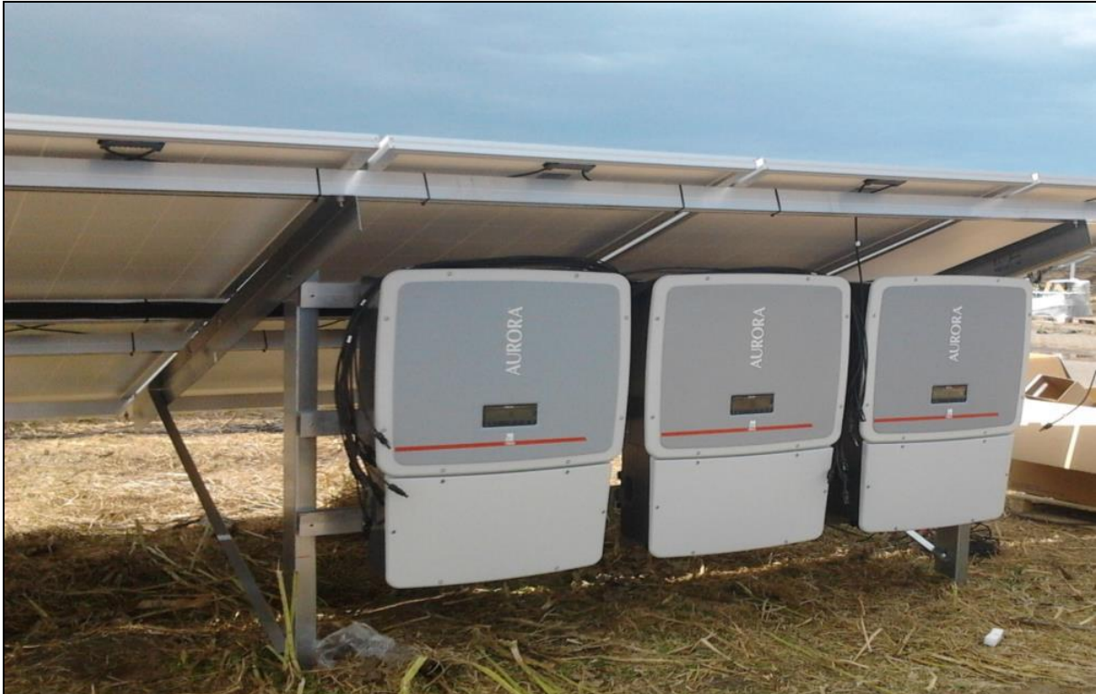
Fotografia nr 10. Przykład instalowania inwerterów pod panelami.
