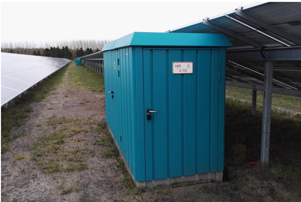
Rysunek 12 Obiekt stacji transformatorowej o mocy 0,5 MVA.
