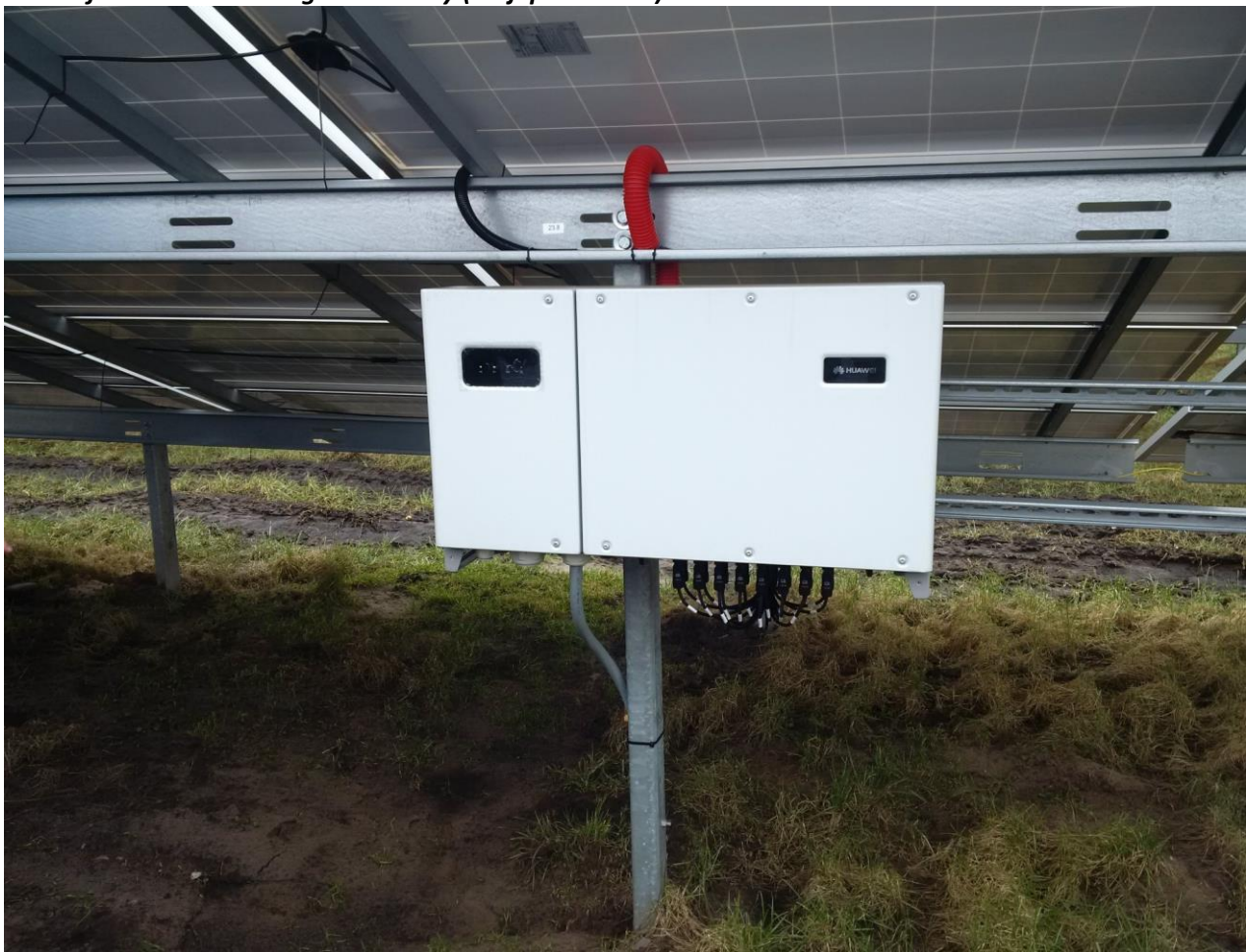
Rysunek 11 Inwerter o mocy 42 kW zamocowany na konstrukcji nośnej paneli fotowoltaicznych
