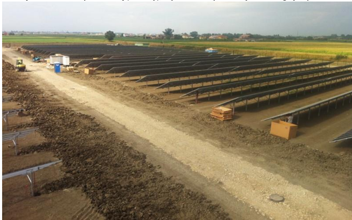
Rysunek 21 Farma na jednym z ostatnich etapów budowy, po montażu modułów i zasypaniu przewodów
