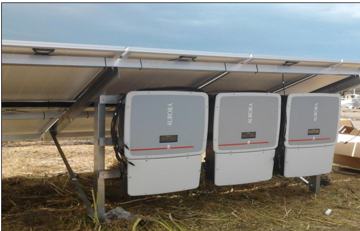
Fotografia nr 10. Przykład instalowania inwerterów pod panelami.
