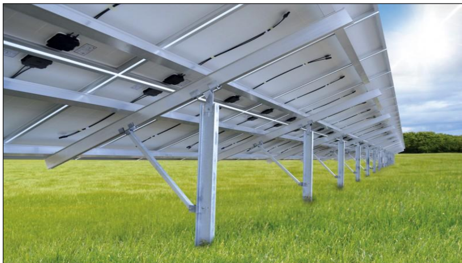
Rysunek 2: Stelaże wykorzystywane do montażu paneli fotowoltaicznych.
