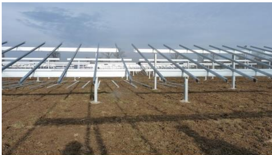
Zdj.1b. Przykład konstrukcji stelażowej służącej do montażu paneli fotowoltaicznych (na podst. chronymy klimat.pl )
