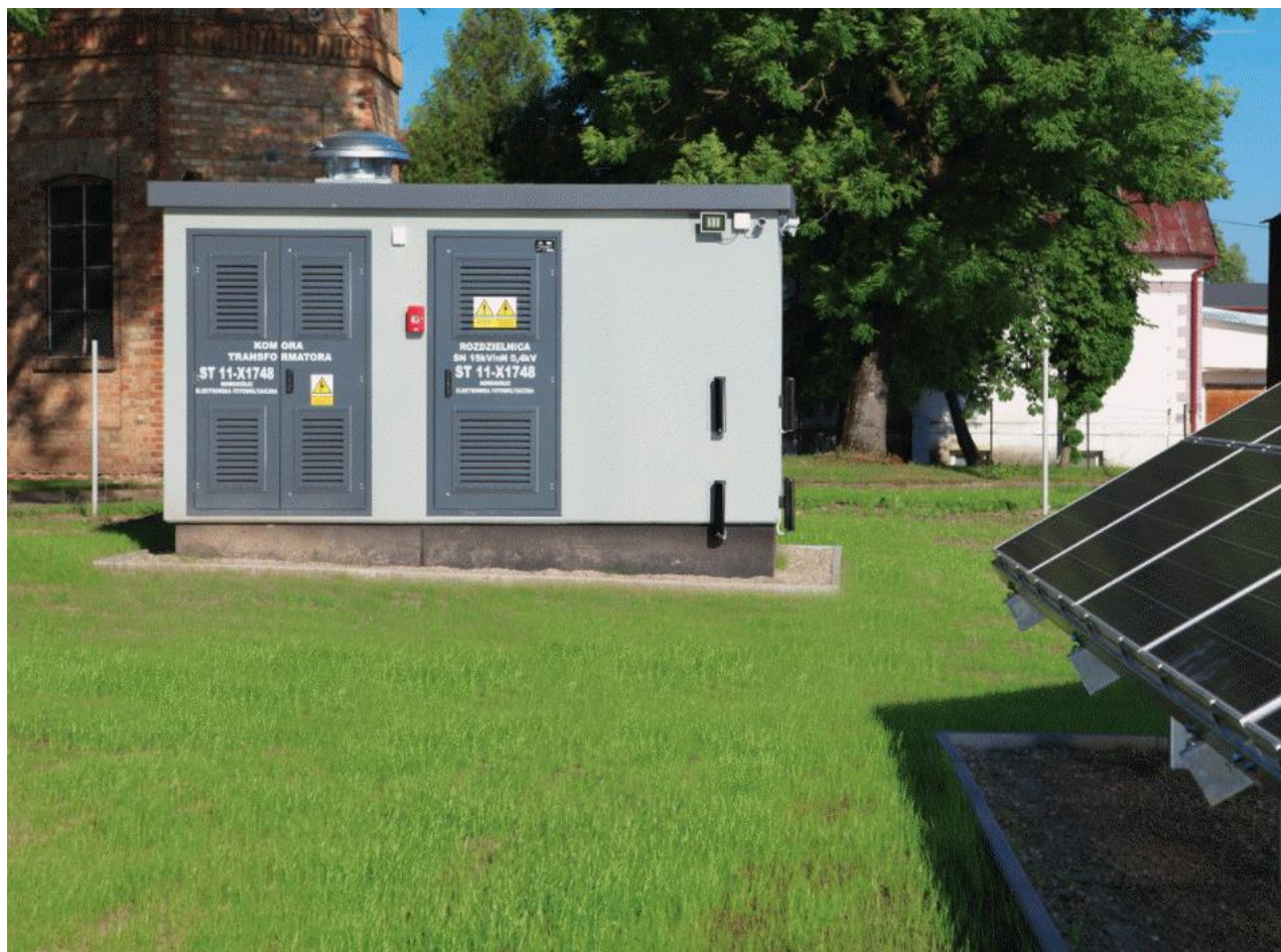
Zdj.3. Przykład kontenerowej stacji transformatorowej, w której umieszczony jest transformator (na podst. gosolar.pl)
