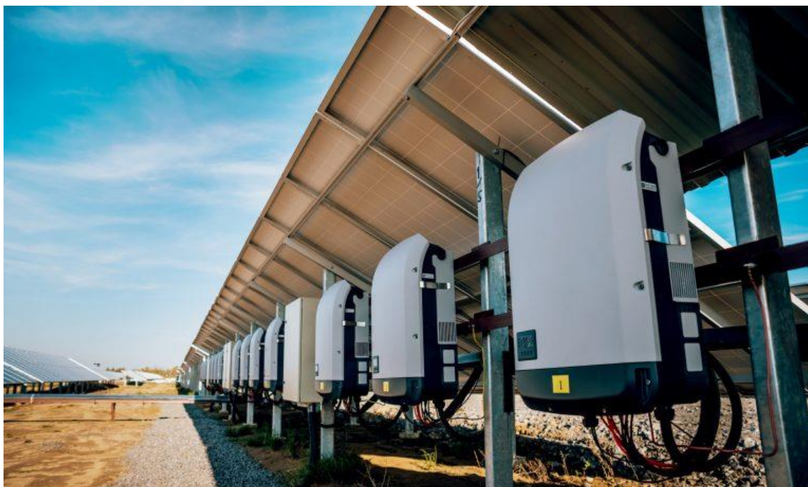
Zdj. 2 Przykład inwerterów na farmie fotowoltaicznej
