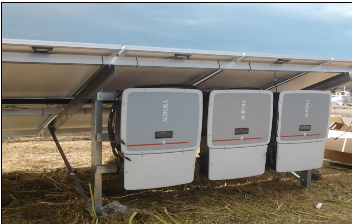
Fotografia nr 10. Przykład instalowania inwerterów pod panelami.
