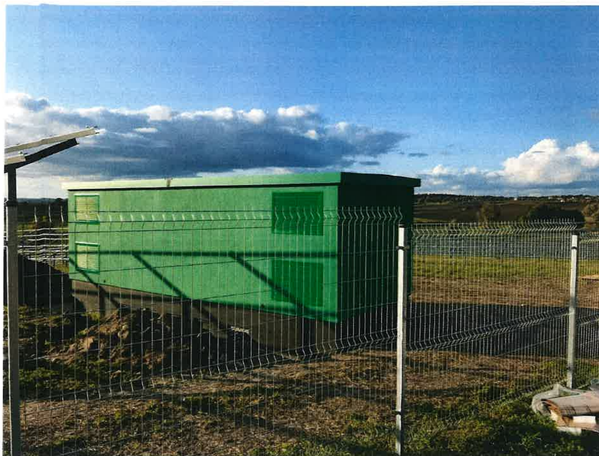
Ryc. nr 11 Przykładowa stacja transformatorowa
