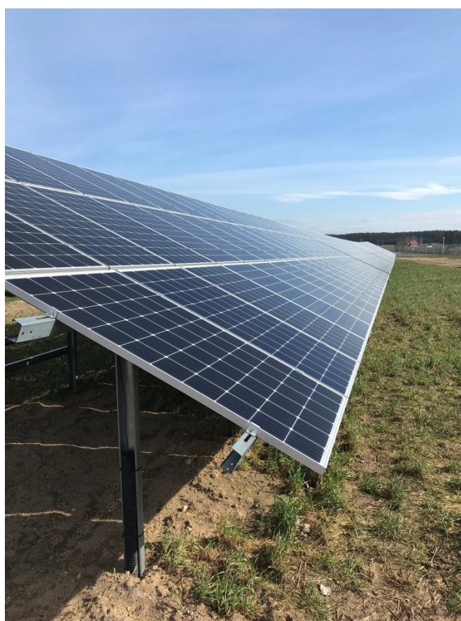
Ryc. nr 7 Przykładowy sposób montażu paneli fotowoltaicznych na stelażach wbijanych bezpośrednio do gruntu
