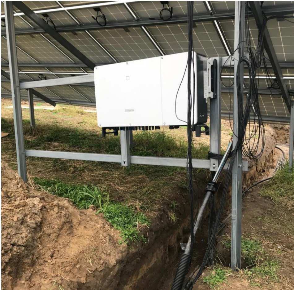
Ryc. nr 6 Przykładowy inwerter mocowany do konstrukcji wsporczej
