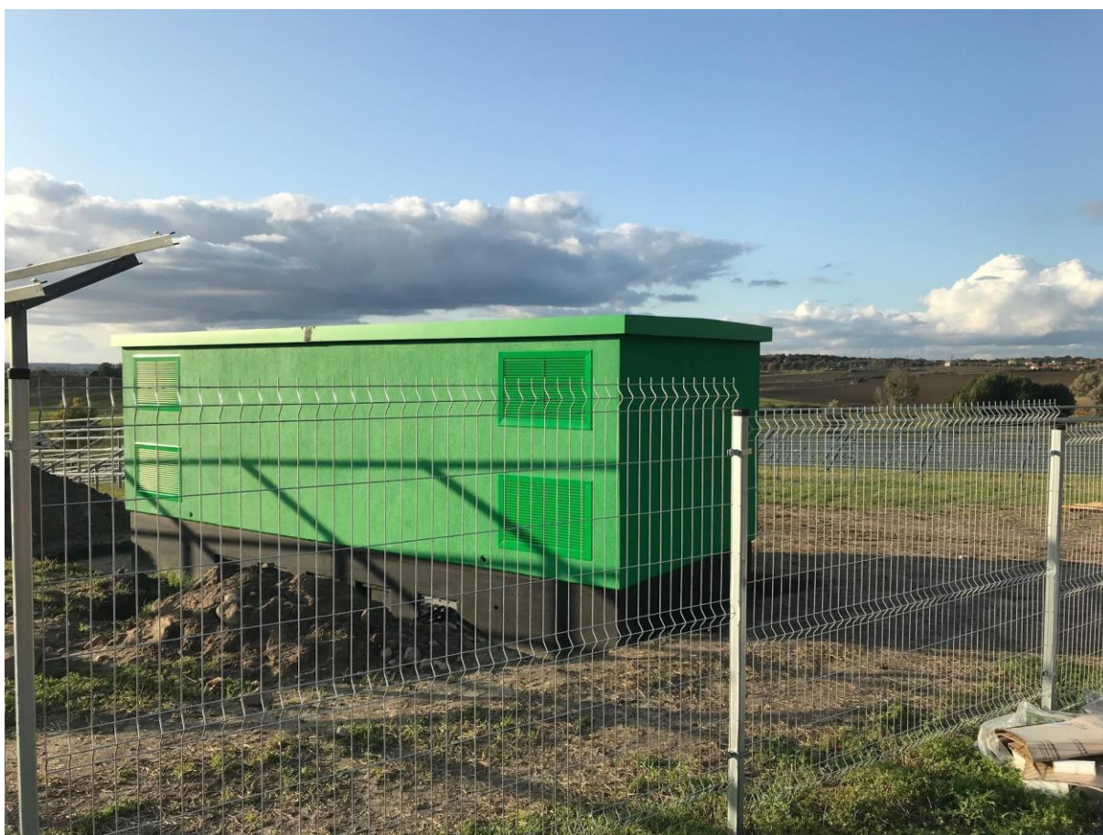
Ryc. nr 7 Przykładowa stacja transformatorowa
