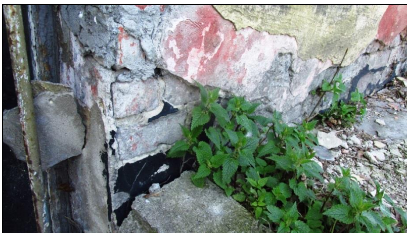
Fot. 10 Uszkodzenia elewacji w partiach przyziemia, rozwijająca się roślinność
