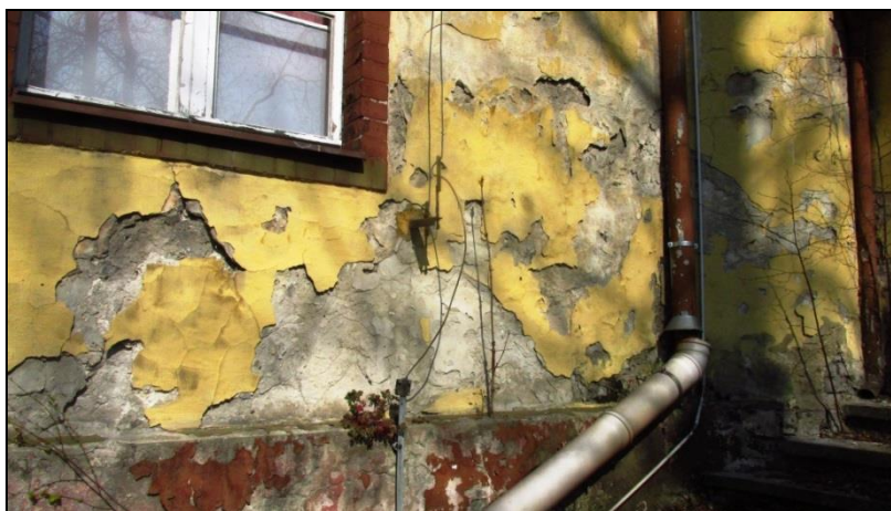
Fot. 17 Uszkodzenia istniejących powłok tynkarskich i malarskich – elewacja południowa
