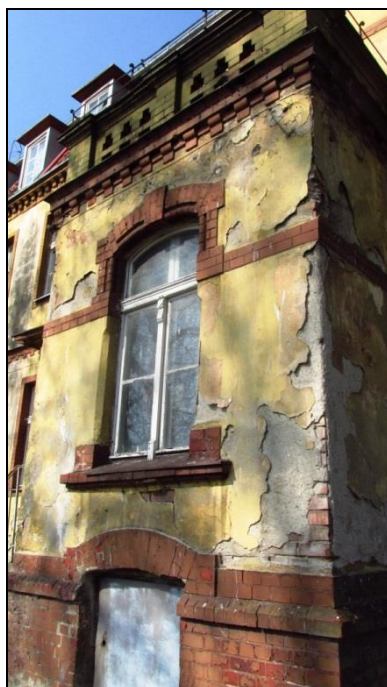
Fot. 18 Uszkodzenia istniejących powłok tynkarskich i malarskich- aneks wschodni elewacji południowej Podczas napraw wykonywanych w obiekcie użyto niedyfuzyjnych powłok malarskich (w odcieniach żółci i zieleni) którymi pokryto powierzchnie tynków, kształtek ceglanych oraz rurę spustową przy elewacji północnej
