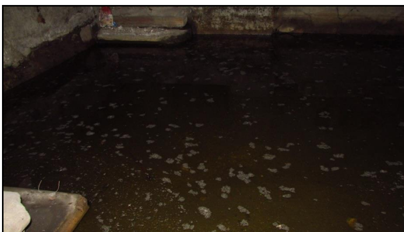
Fot. 41 Poziom wody w niecce piwnicy
