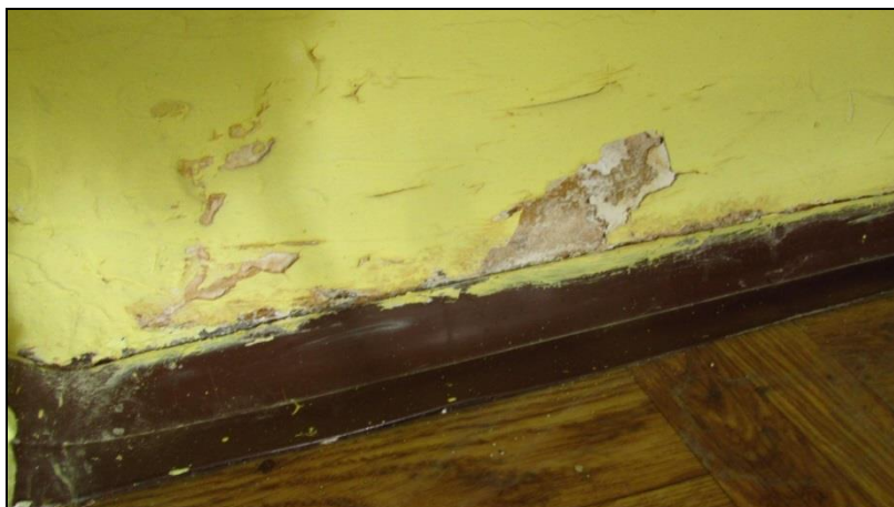
Fot.43 Destrukcja powłok na ścianach wewnętrznych parteru
