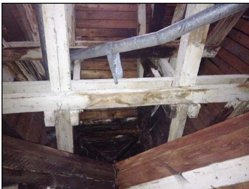
Fot.46 Zawilgocone i skorodowane elementy konstrukcji więźby dachowej
