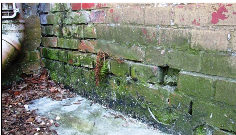
Fot. 8 Porażenia biologiczne ceglanego cokołu, ubytki spoinowania
