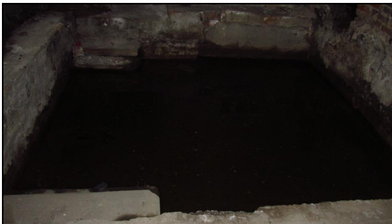
Fot. 40 Zbiornik z wodą w piwnicy
