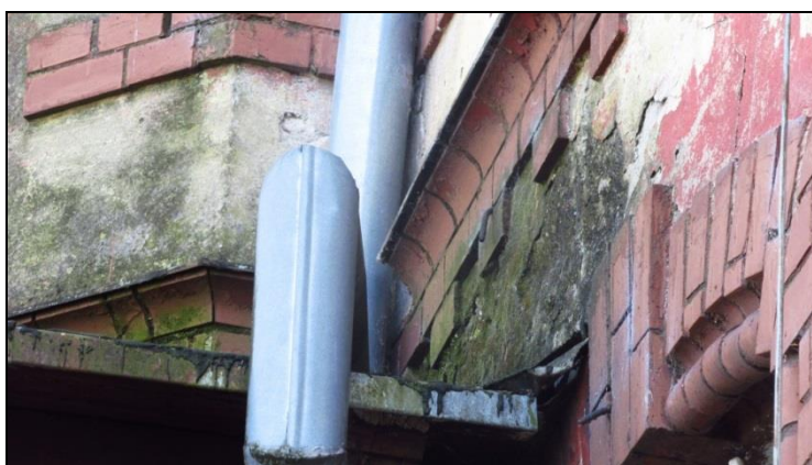
Fot. 14 Porażenia biologiczne ściany w obrębie rury spustowej, nad daszkiem werandy północnej
