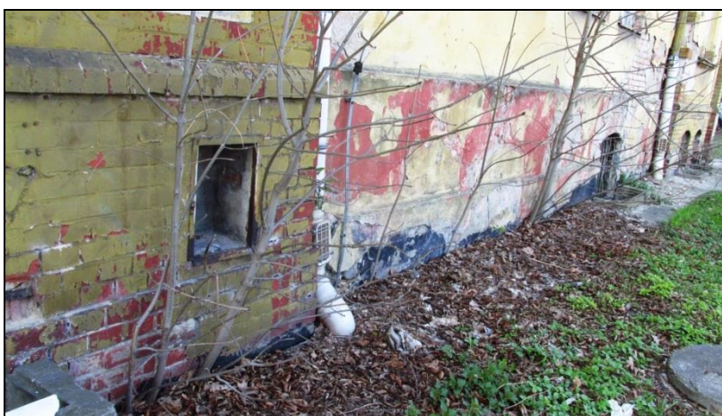
Fot. 11 Roślinność drzewiasta rozwijająca się wzdłuż elewacji wschodniej budynku
