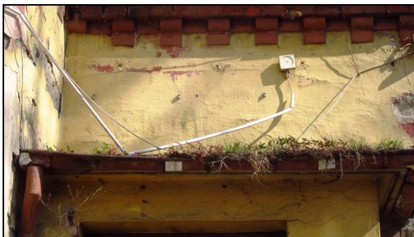
Fot. 50 Rynna i daszek nad wejściem po stronie południowej, widoczne elementy instalacji elektrycznej
