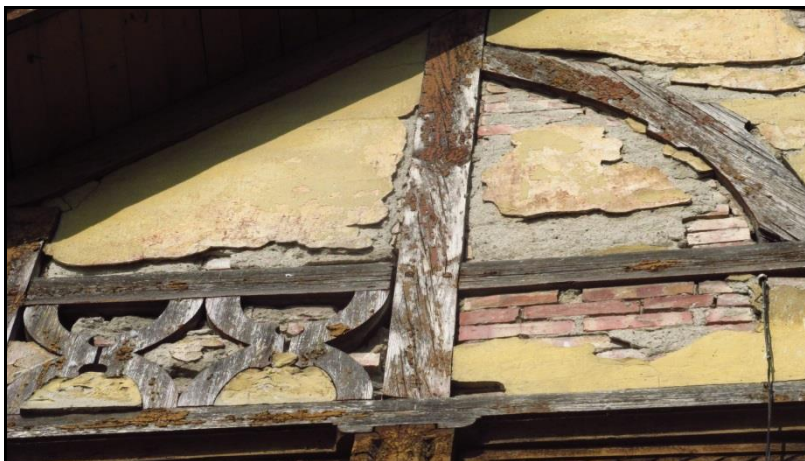
Fot. 31 Fragment drewnianego elementu dekoracyjnego- odspojenia wtórnych powłok, elementy częściowo skorodowane
