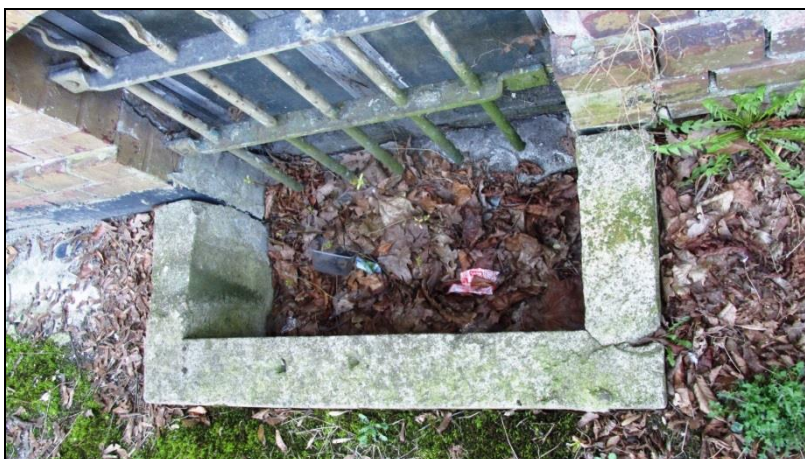
Fot. 25 Niedrożna studzienka przy oknie piwnicznym otoczona betonowymi ściankami
