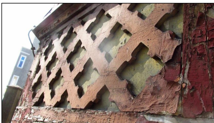
Fot.28 Fragment ozdobnej konstrukcji drewnianej aneksu przy elewacji południowej – odpajające się warstwy farby oraz drobne uszkodzenia
