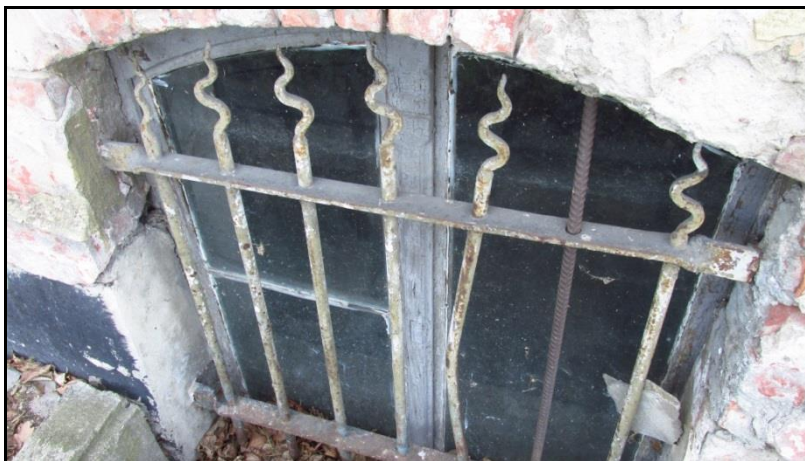
Fot. 36 Skorodowane elementy metalowe okratowania okna, współczesne uzupełnienie niezgodne z oryginalną formą
