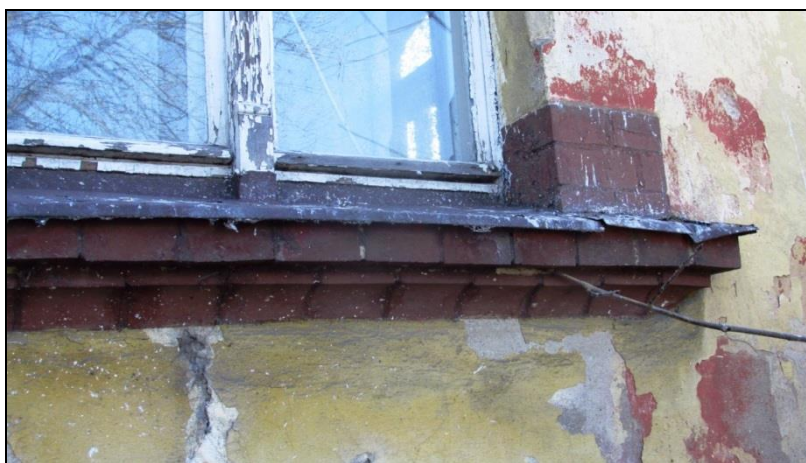
Fot. 54 Skorodowany i uszkodzony parapet
