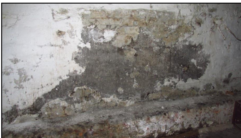
Fot.37 Ściana piwniczna- zawilgocenia i uszkodzenia tynków wewnętrznych
