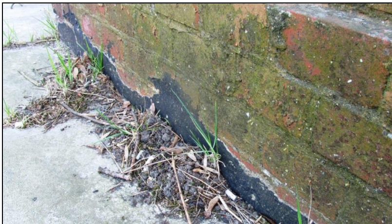
Fot. 12 Porażenia biologiczne partii przyziemia muru, widoczne fragmenty starej izolacji pionowej z bitumów
