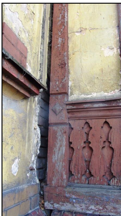
Fot. 32 Brak powiązania konstrukcji werandy północnej z murem
