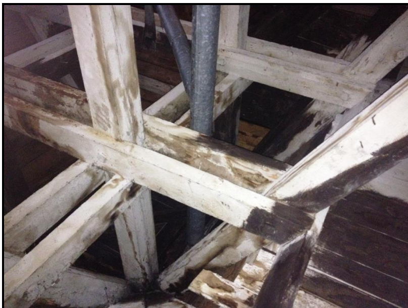
Fot.45 Zawilgocone i skorodowane elementy konstrukcji więźby dachowej
