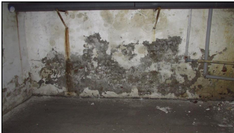
Fot. 38 Porażone i uszkodzone tynki na powierzchniach ściany piwnicznej
