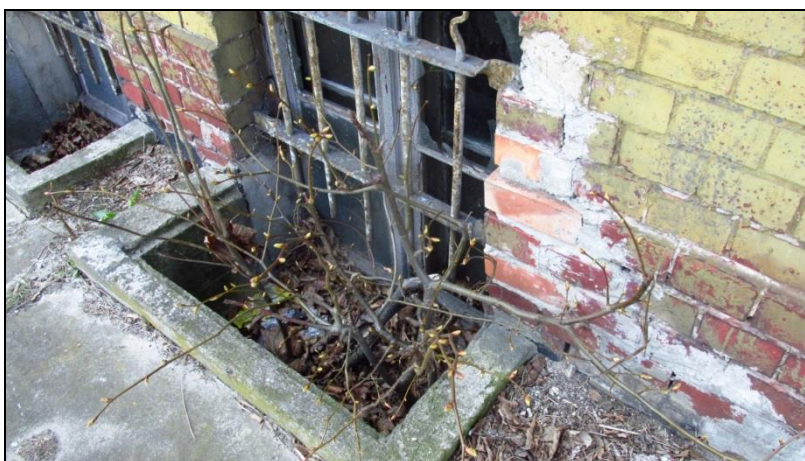
Fot. 26 Niedrożna studzienka, rozwijająca się roślinność
