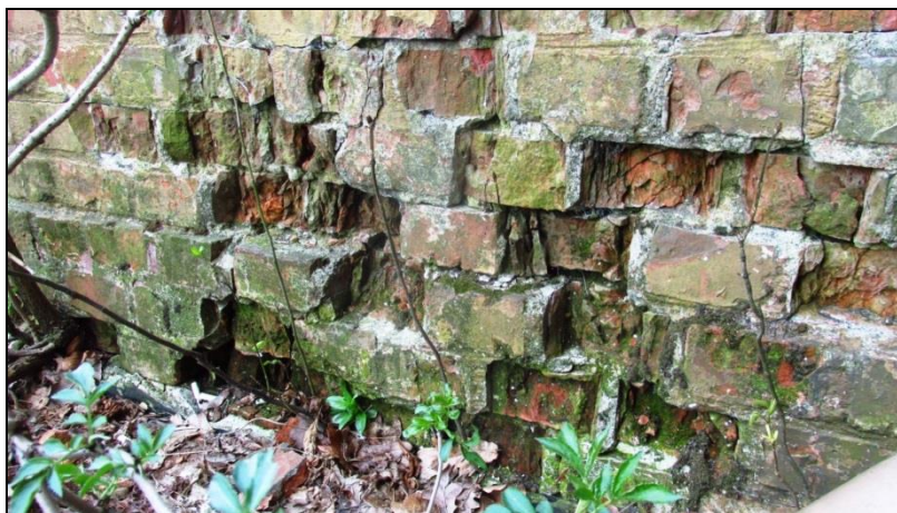
Fot. 5 Zdegradowane i porażone biologicznie partie przyziemia muru
