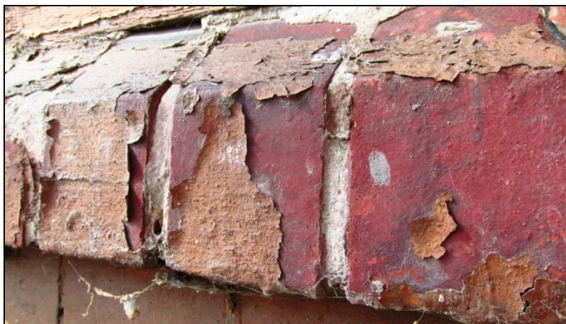
Fot. 21 Rolka nad cokołem- odspojenia wtórnych powłok malarskich z cegły
