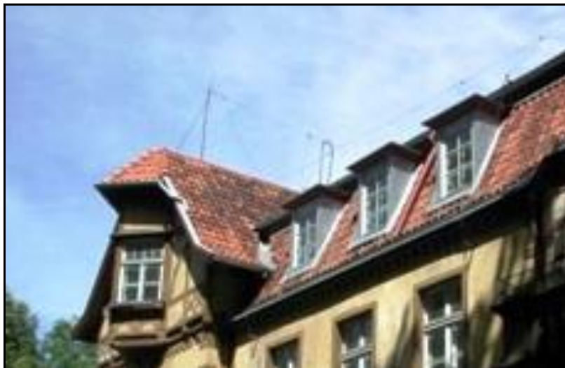
Fot.47 Istniejące pokrycie z dachówki ceramicznej
