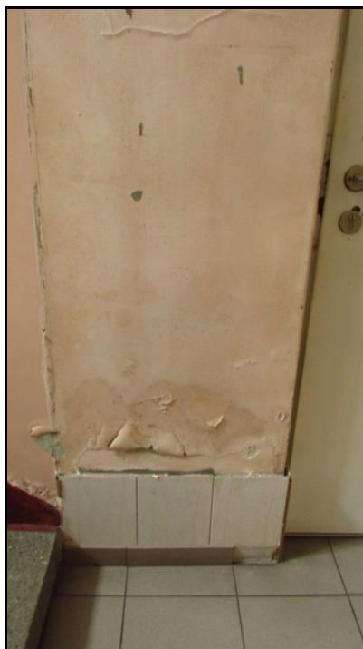
Fot.44 Zawilgocone i odspajające się powłoki malarskie na ścianie klatki schodowej parteru
