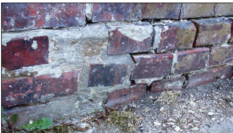
Fot. 7 Partie przyziemia muru- zanieczyszczenia, brak spoin
