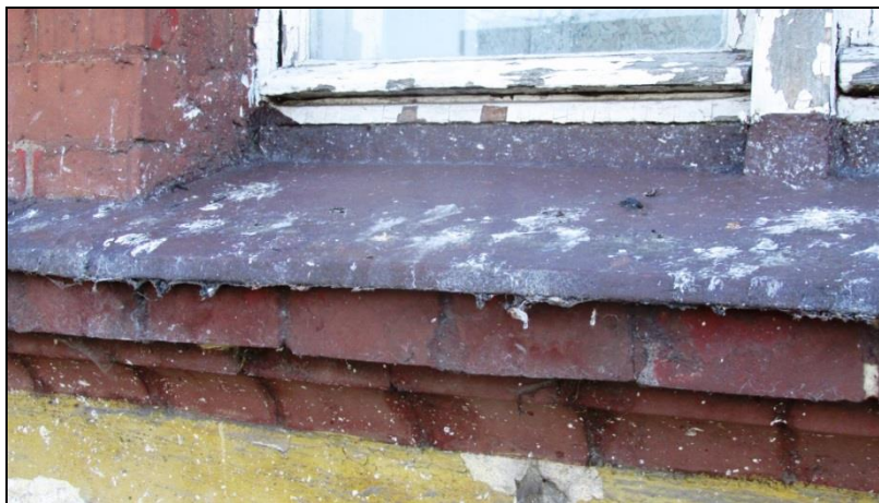
Fot. 55 Nieprawidłowo ukształtowany parapet blaszany
