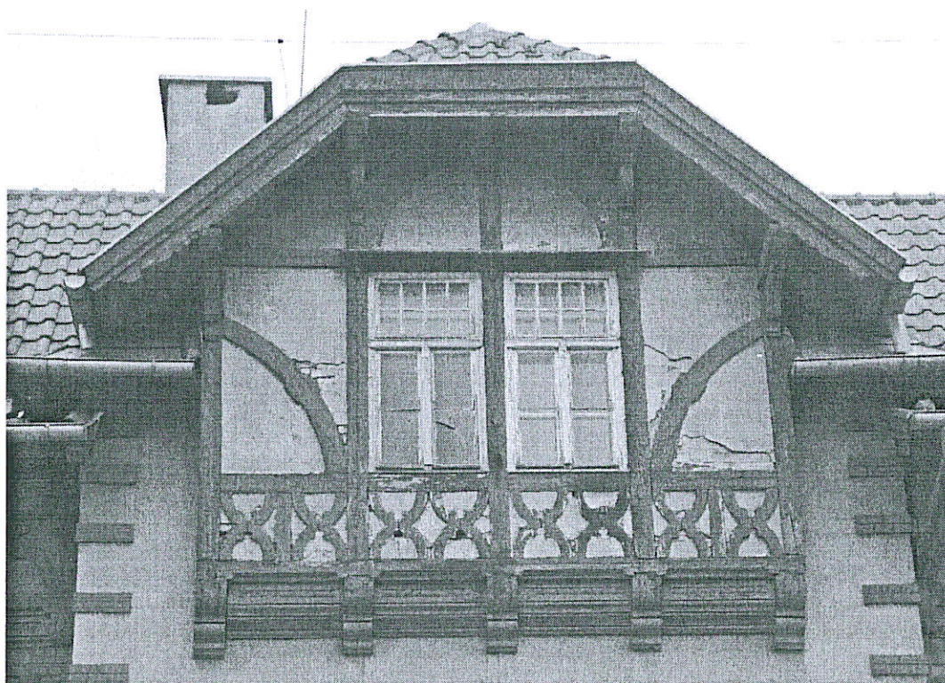
WYKUSZ NA ELEWACJI FRONTOWEJ
