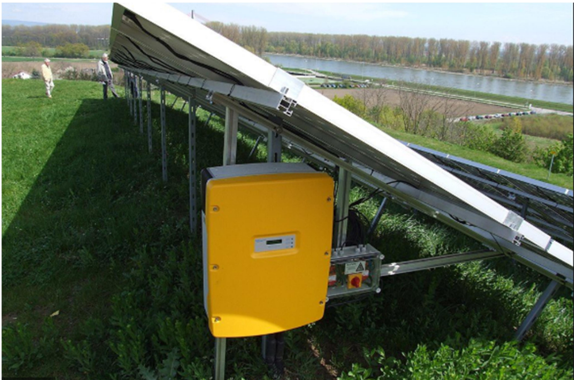
Zdjęcie 4 Przykładowy inwerter farmy fotowoltaicznej.
