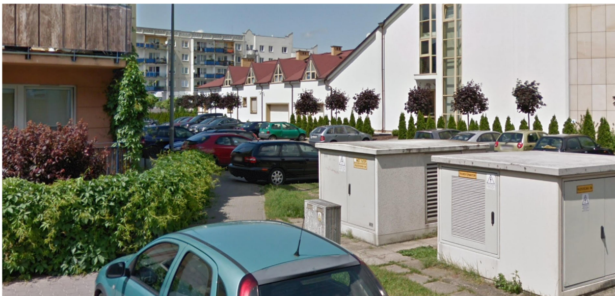
Zdjęcie 5 Standardowe stacje kontenerowe w otoczeniu zabudowy.
