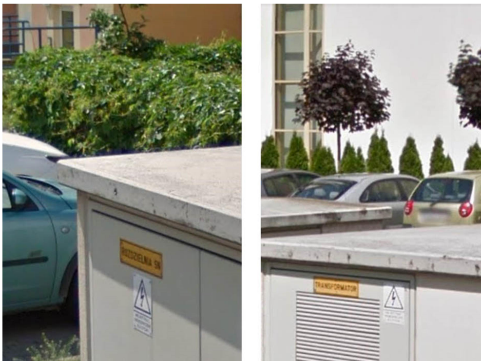
Zdjęcie 7 Stacja transformatorowa SN z rozdzielnią SN
