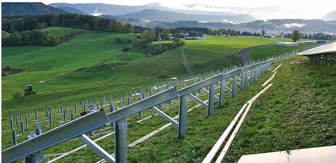
Zdjęcie 3 Konstrukcja przeznaczona do posadowienia paneli fotowoltaicznych.
