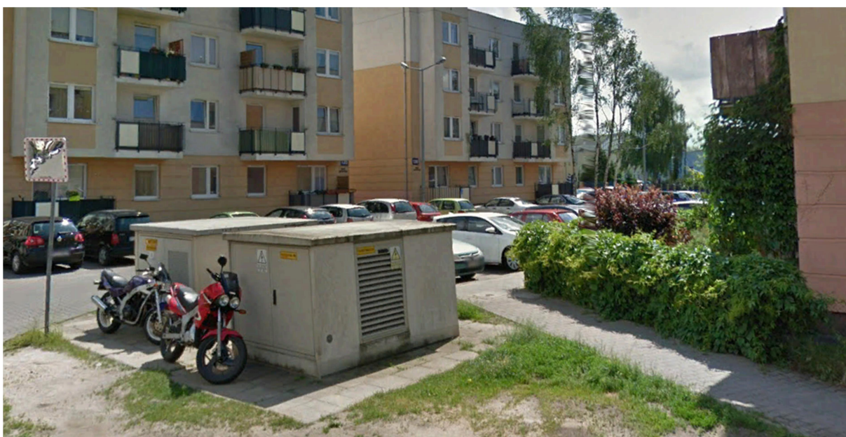
Zdjęcie 6 Stacje transformatorowe w otoczeniu zabudowy.
