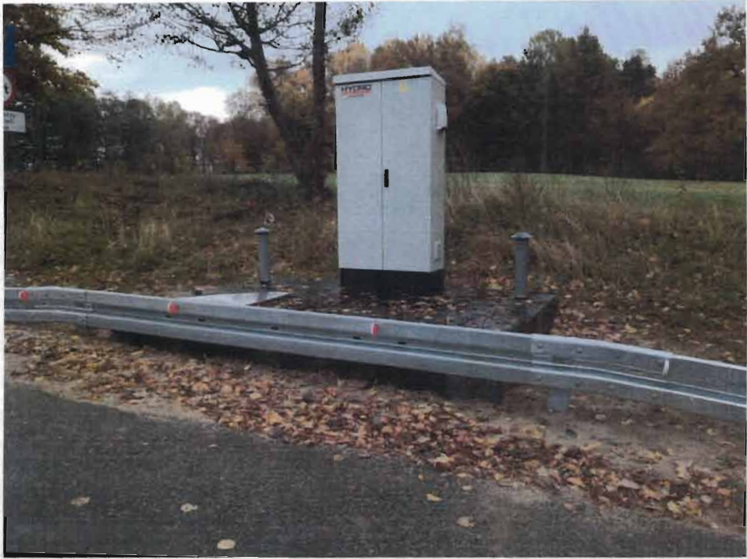
Stacja podnoszenia ciśnienia wody Czechowo SPCW2
